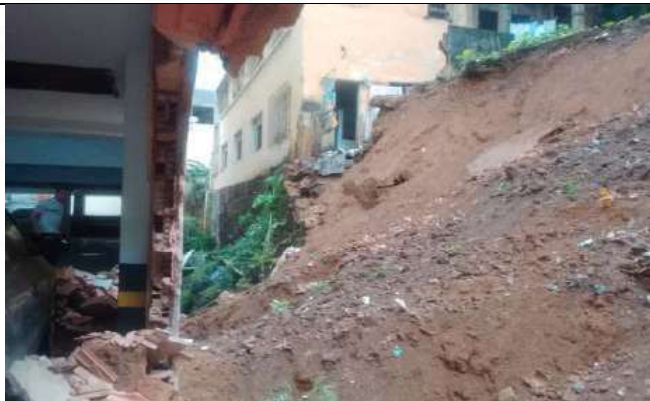
Rua Washington Pessoa, nº 128, Bloco B; Rua Máximo Borgo, nº 36, Escadaria Santa Cecília; Rua Antenor Guimarães, nº 55, Santa Clara – 01/12/22
